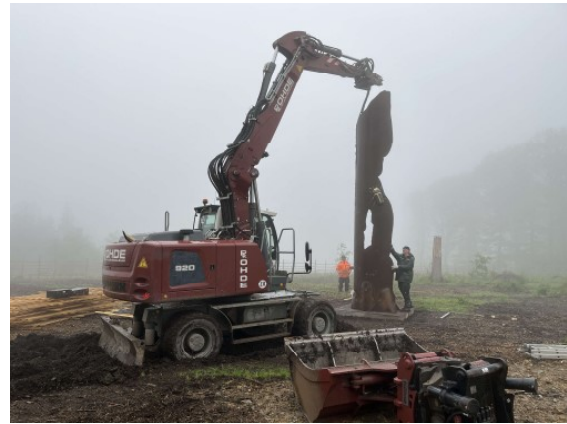
(Auch die Firma Rohde hat mit schweren Maschinen unterstützt. Hier beim Aufstellen der Skulptur „Waldwandel“, Besenbinderhütte)
